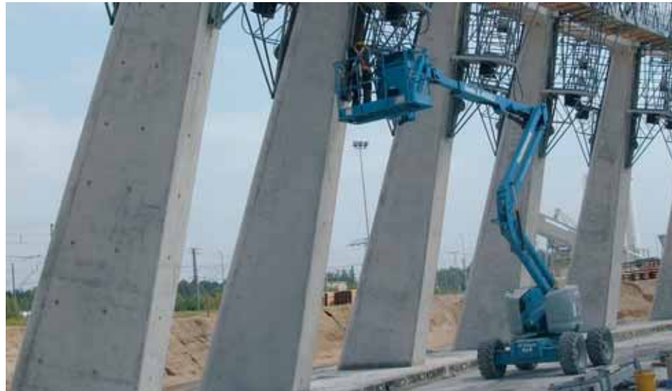
Blick auf die Stützen des Naturzugnasskühlturms in Boxberg
