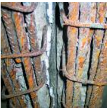
Freigelegte Bewehrung eines Unterzuges im Dehnungsfugenbereich
