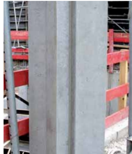
Festigkeitsklasse C 80/95, Sichtbetonklasse SB 2: Stütze im Biomedizinischen Forschungszentrum Seltersberg der Universität Gießen
